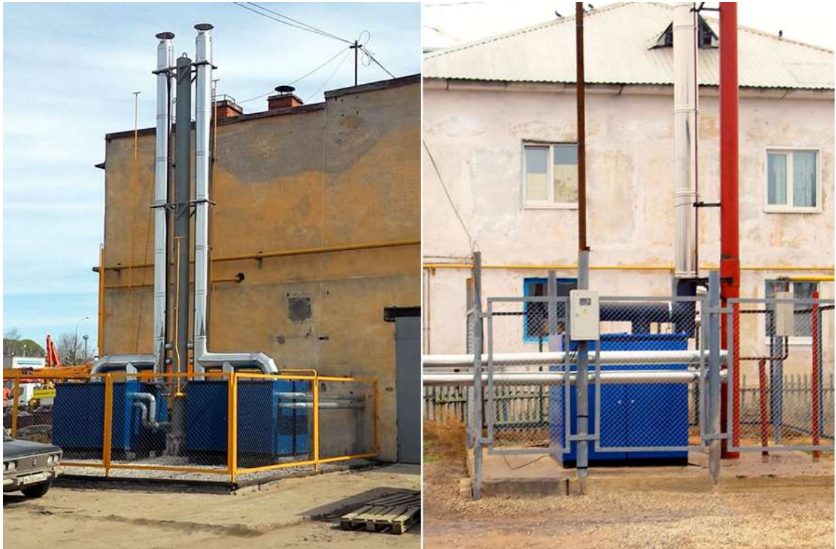
Рисунок 18 – Примеры использования котлов наружного размещения
