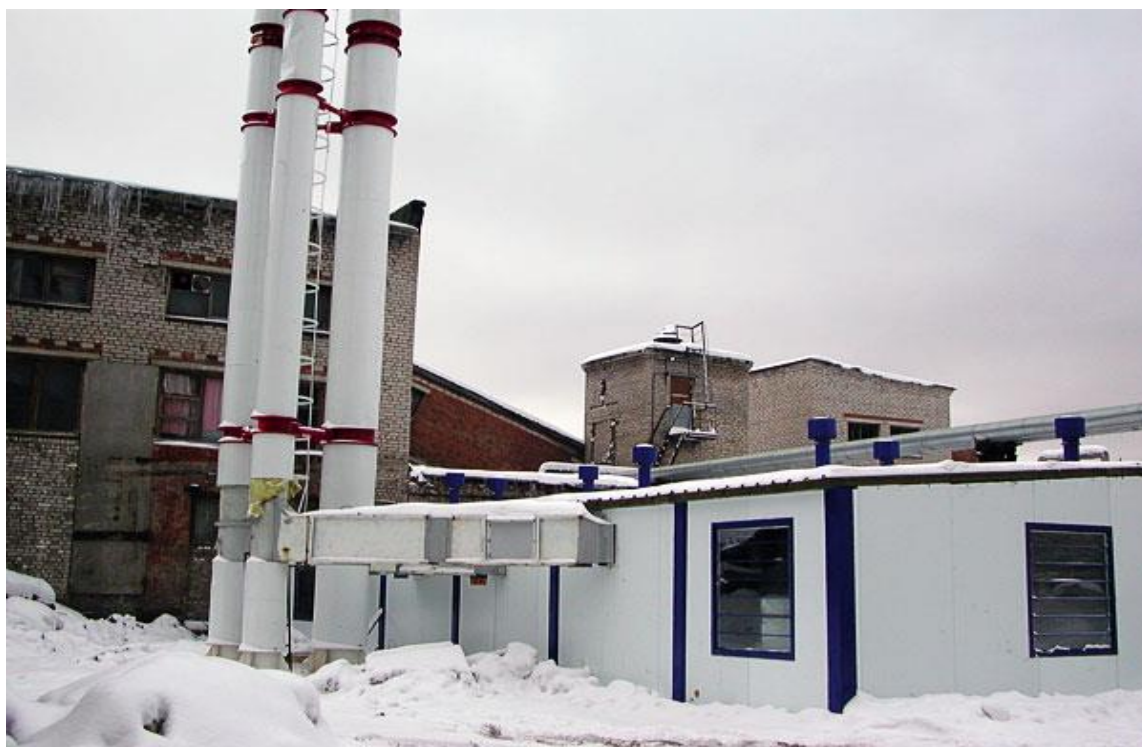
Рис. 1.2.8. Блочно-модульная котельная микрорайона Каринторфф
